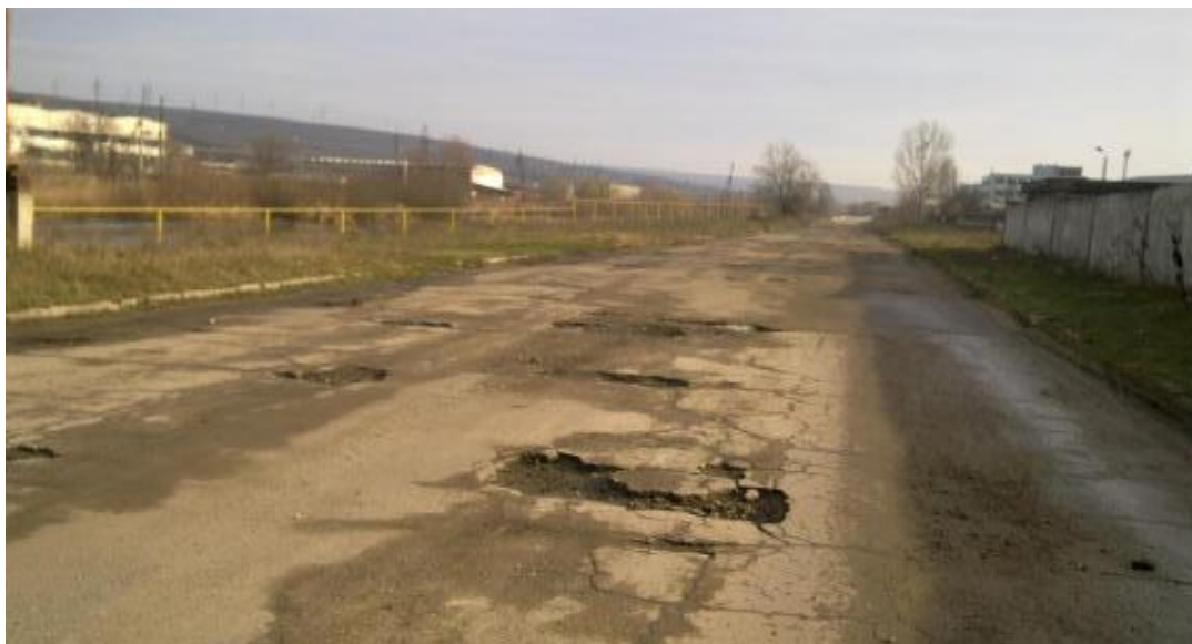
Foto 2. Starea drumului de la șoseaua Chișinău - Ungheni până la întreprindere
